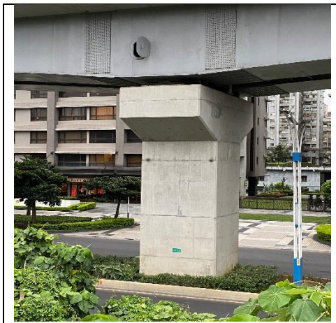
圖 5-12 G096 檢修孔未定位
